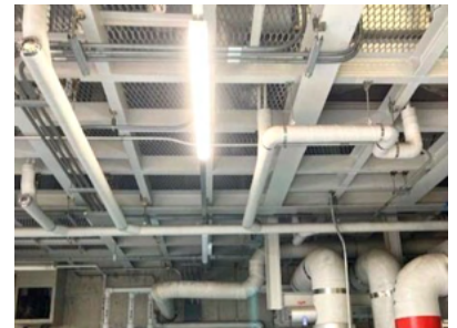
熱供給プラント (神奈川県横浜市)
